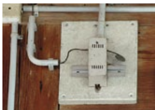
Panneau léger contenant de l'amiante
