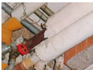
Mortier amianté (isolation de conduites)
